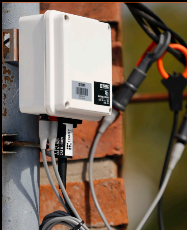
Instalación de PQ1 MP acometida aérea
